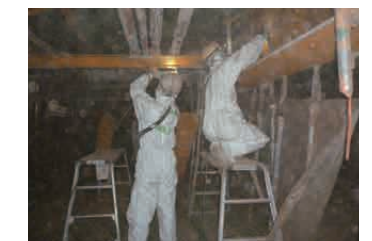
高速道路耐久性向上工事、鉛中毒災害
