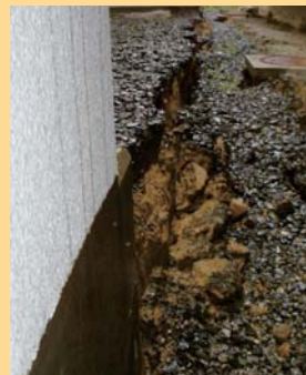
病院建物周囲の地盤の亀裂
