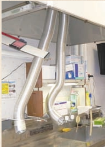
図2 病院病理部ダクトの改善後
